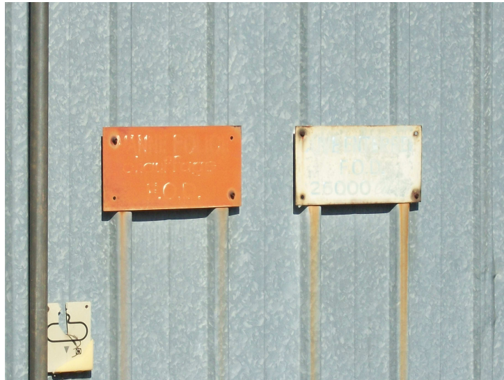
Vue du local de la cuve FOD à l'arrière du site
