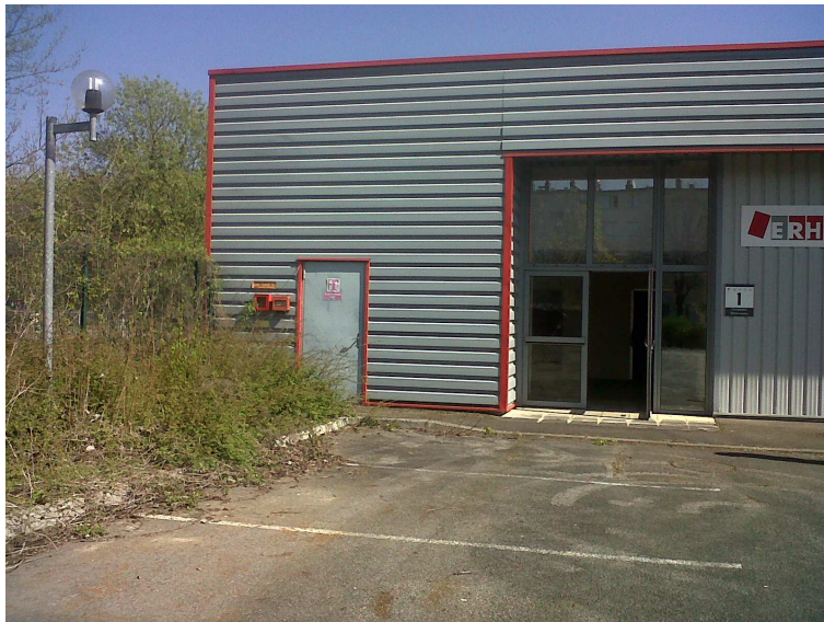
Vues de l'extérieur et de l'intérieur du local chaufferie attendant le showroom désaffecté
