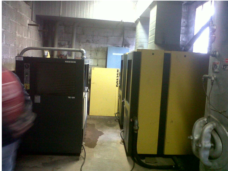
Vue du local compresseur dans le bâtiment principal
