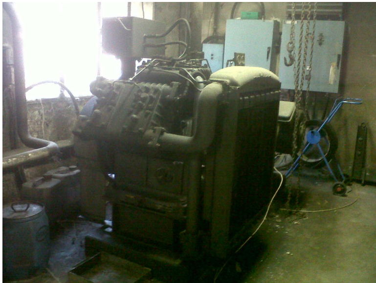
Ancien moteur en état d'usage dans le local compresseur
